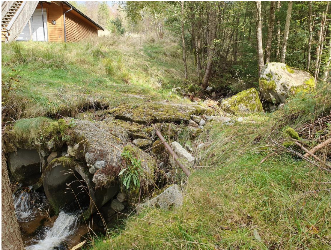
Foto 6 Ødelagt betongbru ved Klovsteinsbekken
