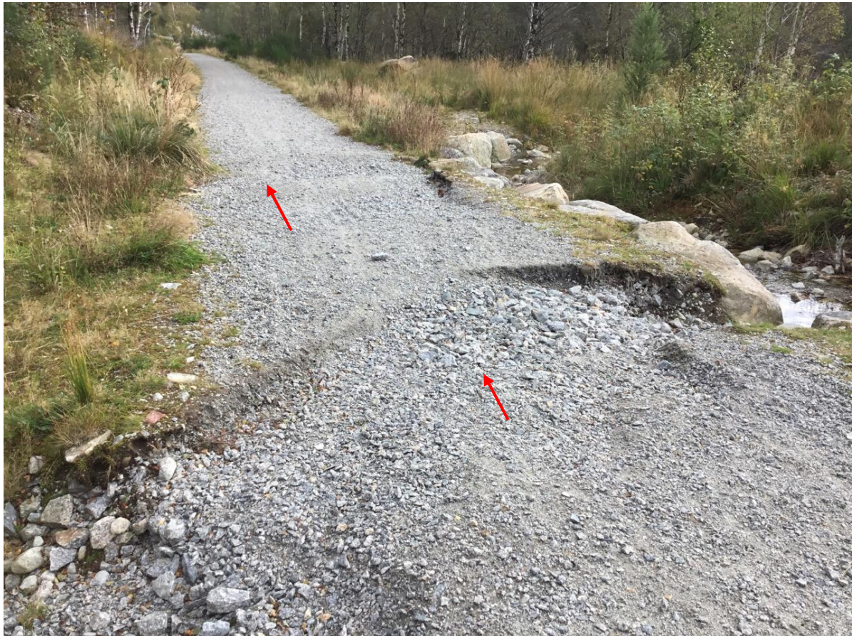
Foto 9 Skader på turvei i forbindelse med bekker/stikkrenner
