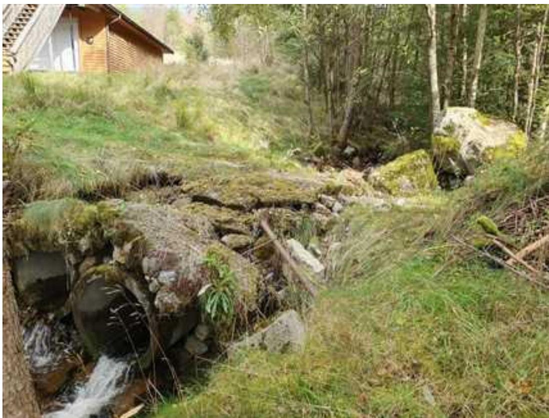
Foto 6 Ødelagt betongbru ved Klovsteinsbekken
