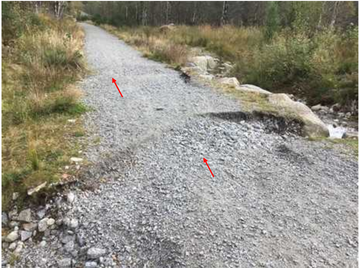
Foto 9 Skader på turvei i forbindelse med bekker/stikkrenner
