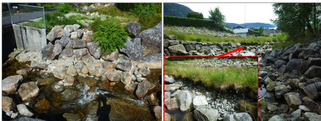
Figur 9.48 E 5 – Skardbekken, høyre bredd ved Snøkklokkevegen (venstre). E 6 – Skardbekken ved Bergflettevegen, sidesikringen har rast ut på venstre bredd (høyre).
